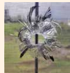
Durchschossenes Fenster in Sweida
